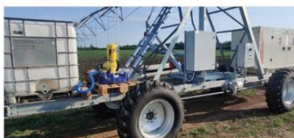
Установка системи фертигації (внесення добрив)
